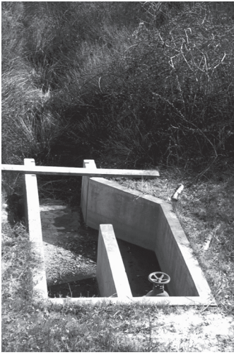
Pêcherie extérieure bétonnée (3 x 2 m) avec vanne de vidange en sortie de buse, sur un petit étang (1 ha), Dordogne. (Photo O. Schlumberger)
