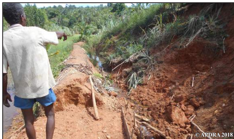
Casse de la digue de M. Boto Edmond
